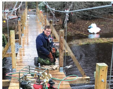
L'artisan Szustakowski (FCE) qui participe à la construction du pont suspendu à Ingonish (2017).
